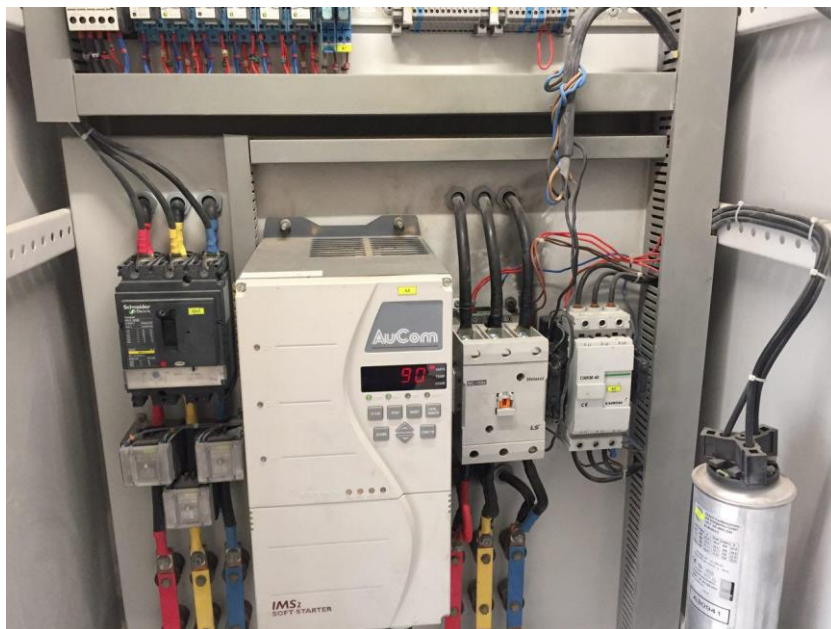
شکل ۶. نمایی از تابلو برق ایستگاه پمپاژ آب کشاورزی تجهیز شده به راه‌انداز نرم
