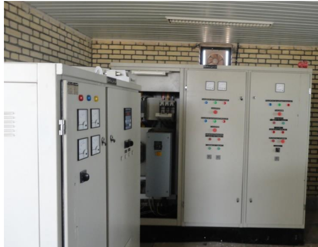
شکل ۸. نمونه‌ای از یک سامانه کنترلی پمپ دور متغیر در ایستگاه پمپاژ آب کشاورزی (شهرستان بيله سوار مغان)
