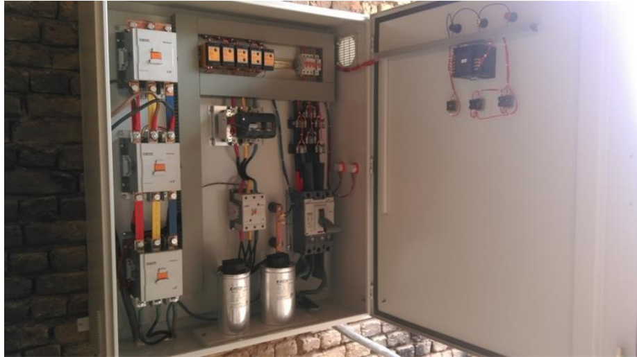
شکل ۵. نمونه‌ای از تابلو برق ایستگاه پمپاژ آب کشاورزی تجهیز شده به بانک خازن
