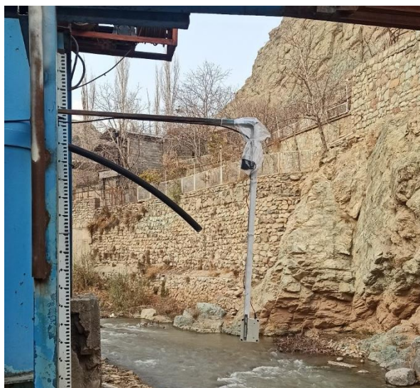
شکل ۱. دستگاه التراسونیک موجود در ایستگاه رودک
