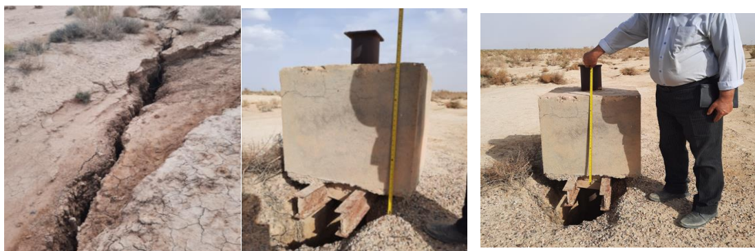
شکل ۸. فرونشست اتفاق افتاده در محدوده دشت دامغان شامل ترک در سطح زمین و فرونشست اطراف پی‌زومتر مشاهداتی
